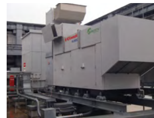
非常用発電機
